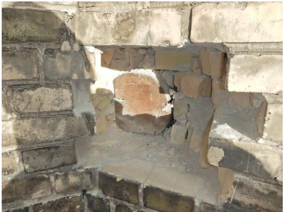
Foto 28: 1. sal. Enden af bjælke B1.12. Ingen nedbrydning.
