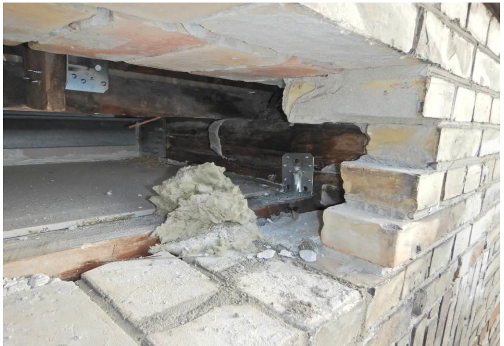
Foto 10: 4. sal. Der kunne ikke ses tegn på nedbrydning i enderne på bjælke B3.4 til B3.6, samt bjælkeremmen mellem B3.5 og B3.6.
