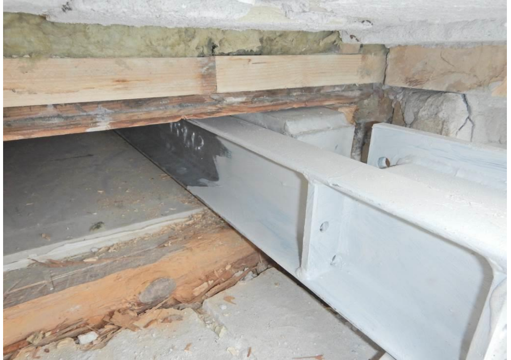
Foto 15: 2. sal. Lettere overfladisk nedbrydning i bjælkerem under bjælke B2.1. Der kunne ikke ses tegn på nedbrydning i enden af bjælke B2.1 og B2.2.
