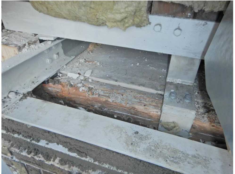
Foto 13: 3. sal. Lettere overfladisk nedbrydning i bjælkerem mellem bjælke B3.10 og B3.11.
