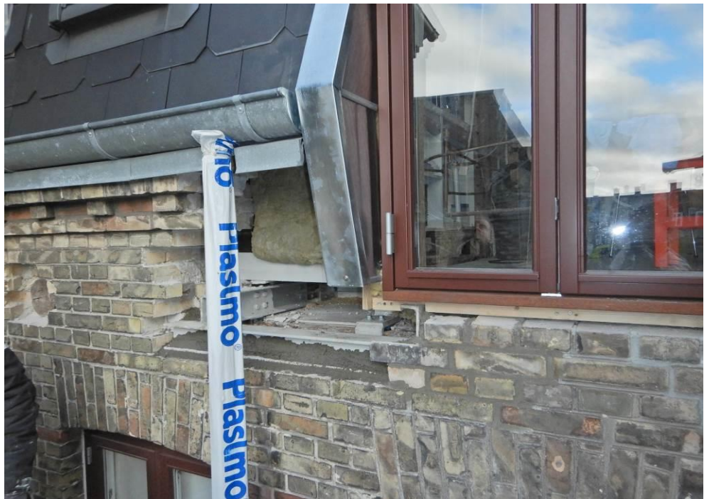
Foto 12: 3. sal. Åbning i ydervæg ind til enden af bjælke B3.10 og B3.11.
