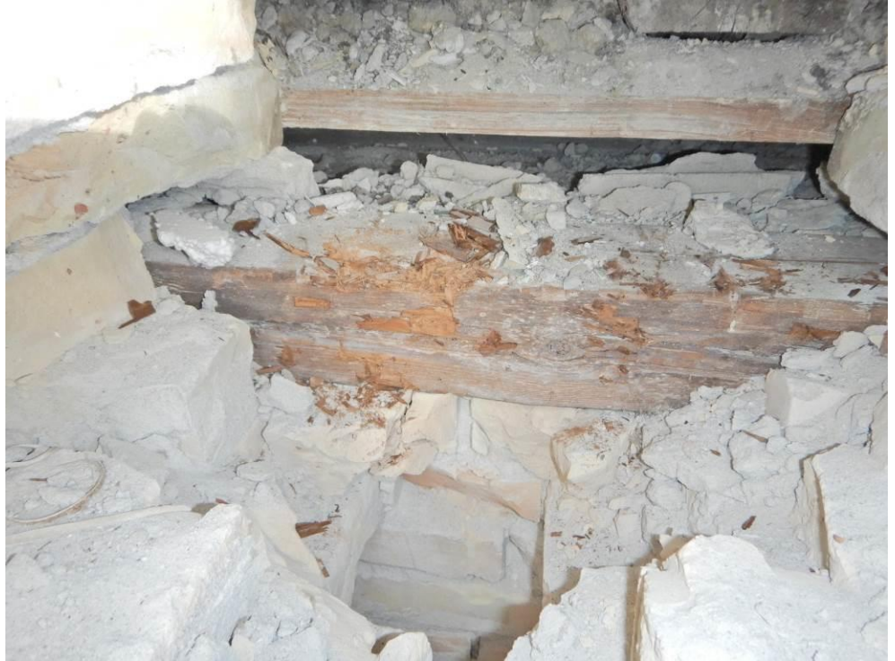
Foto 27: 1. sal. Bjælkerem mellem bjælke B1.10 og B1.11. Letere overfladisk nedbrydning.
