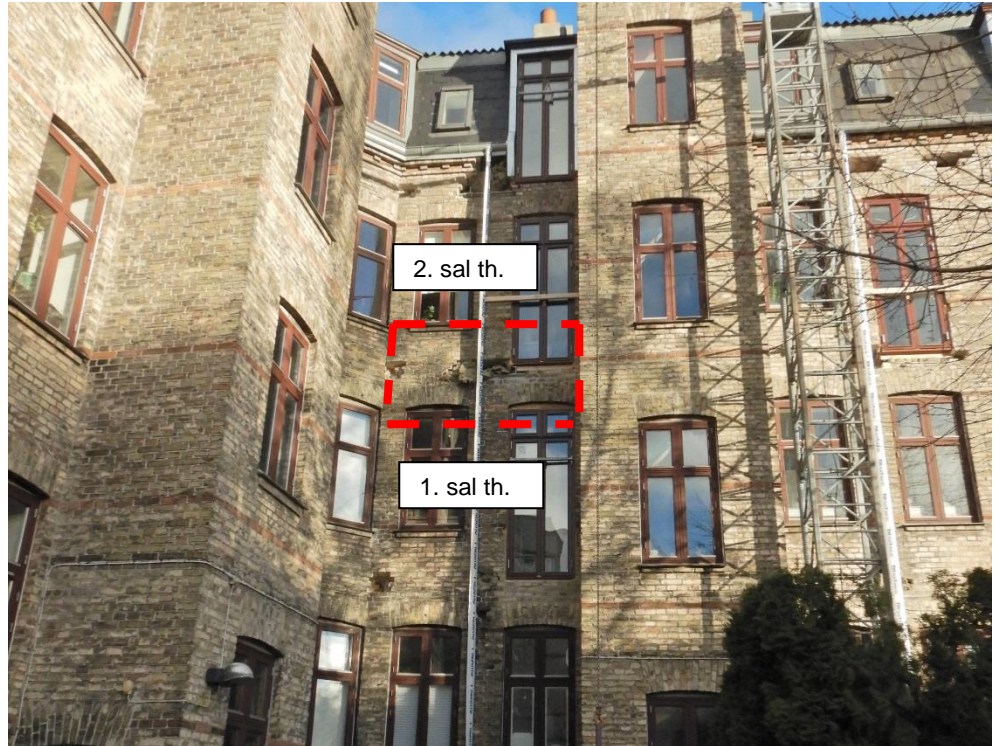
Foto 1: Sydfacade. Foreløbig udbedringsgrænse for angreb af Ægte Hussvamp er markeret med rød stipleet linje.
