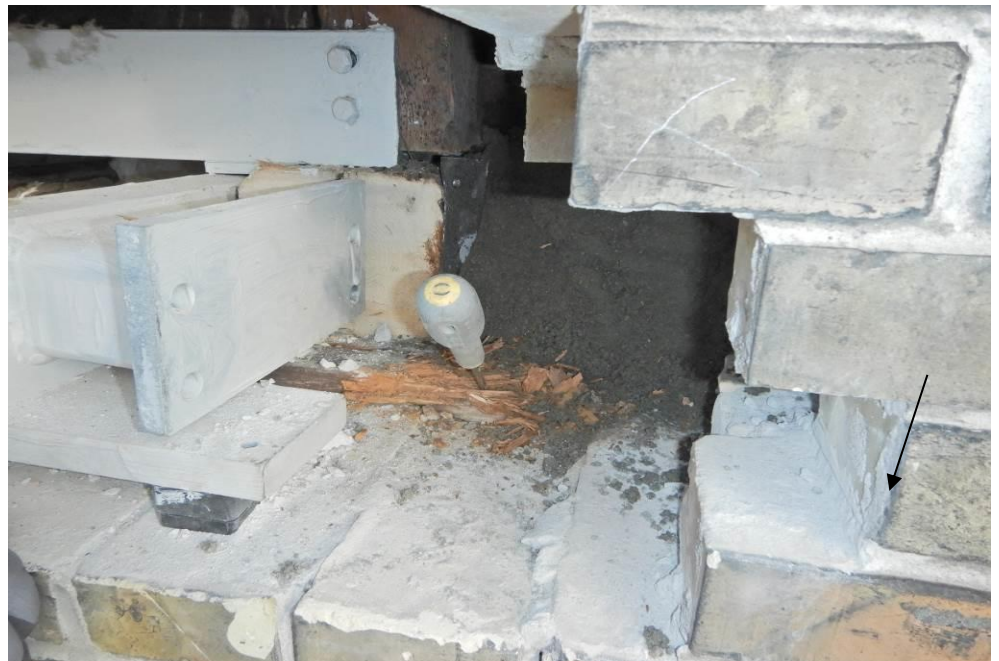
Foto 6: 3. sal. Nedbrydning i enden af bjælkerem under enden af bjælke B3.1. Der kunne ikke ses tegn på nedbrydning i enden af bjælke B3.1 og B3.2.
