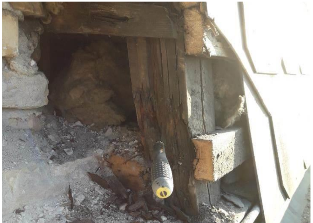
Foto 4: 3. sal: Bjælkelag med angreb af Ægte Hussvamp.
