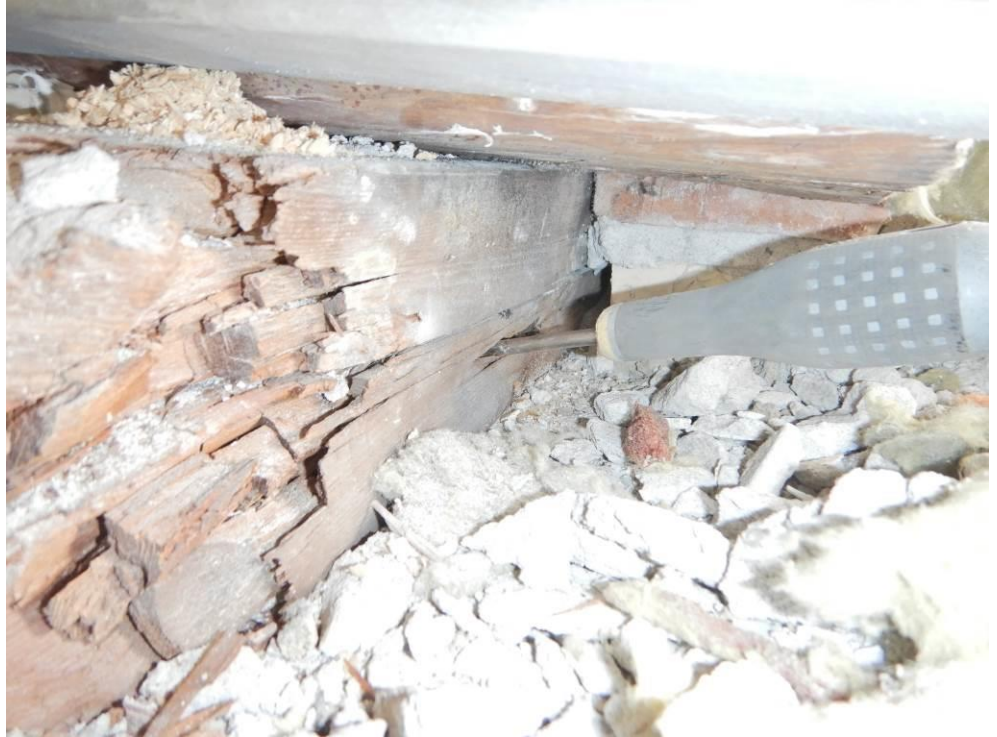
Foto 21: 2. sal. Konstateret angreb og nedbrydning i bjælkerem under bjælke B2.10 forårsaget af Ægte Hussvamp.
