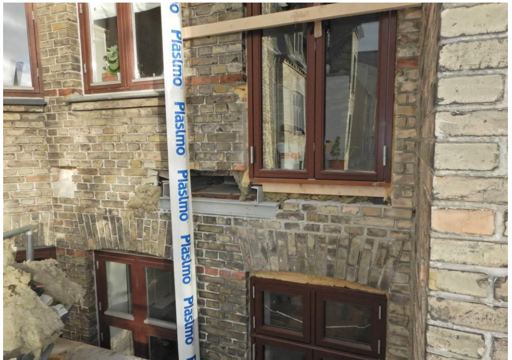
Foto 18: 2. sal. Åbning i ydervæg ind til enden af bjælke B2.10 og B2.11, samt underliggende bjælkerem.
