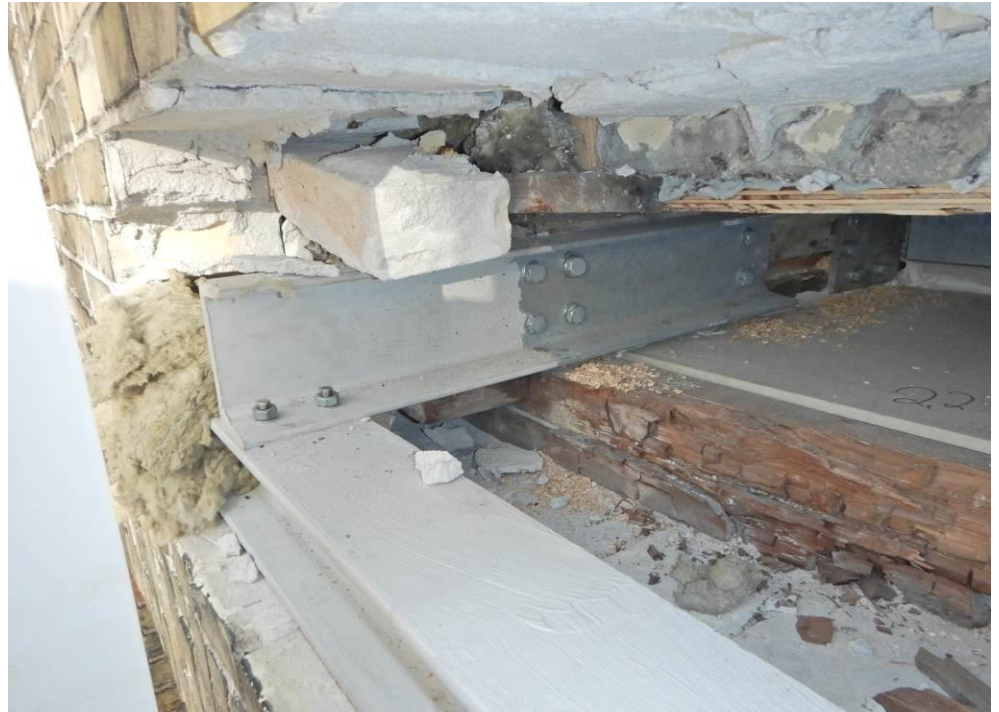
Foto 19: 2. sal. Konstateret angreb og nedbrydning i bjælkerem mellem bjælke B2.10 og B.2.11 forårsaget af Ægte Hus-svamp.
