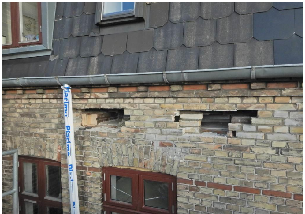
Foto 8: 3. sal. Åbning i ydervæg ind til enden af bjælke B3.4 til B3.6, samt underliggende bjælkerem.
