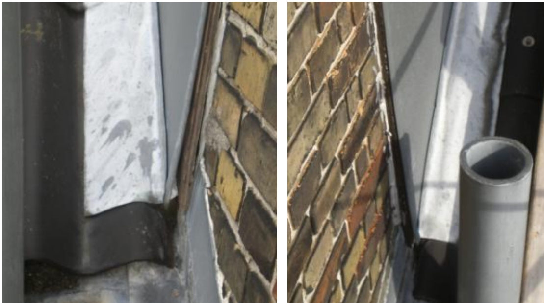
Flunker på bitrapphuse Falkevej 11. Uafdækket endetræ på krydsfiner mellem zink og mur.
