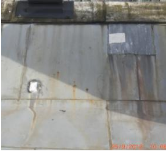
Tidligere reparationer af gennemføringer i zinktag
